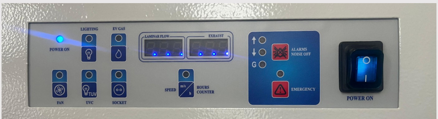
▲ quadro di controllo LED di serie
